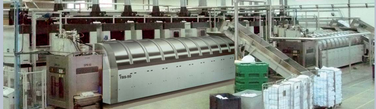
Diseño, instalación y mantenimiento por NEWMATIC
